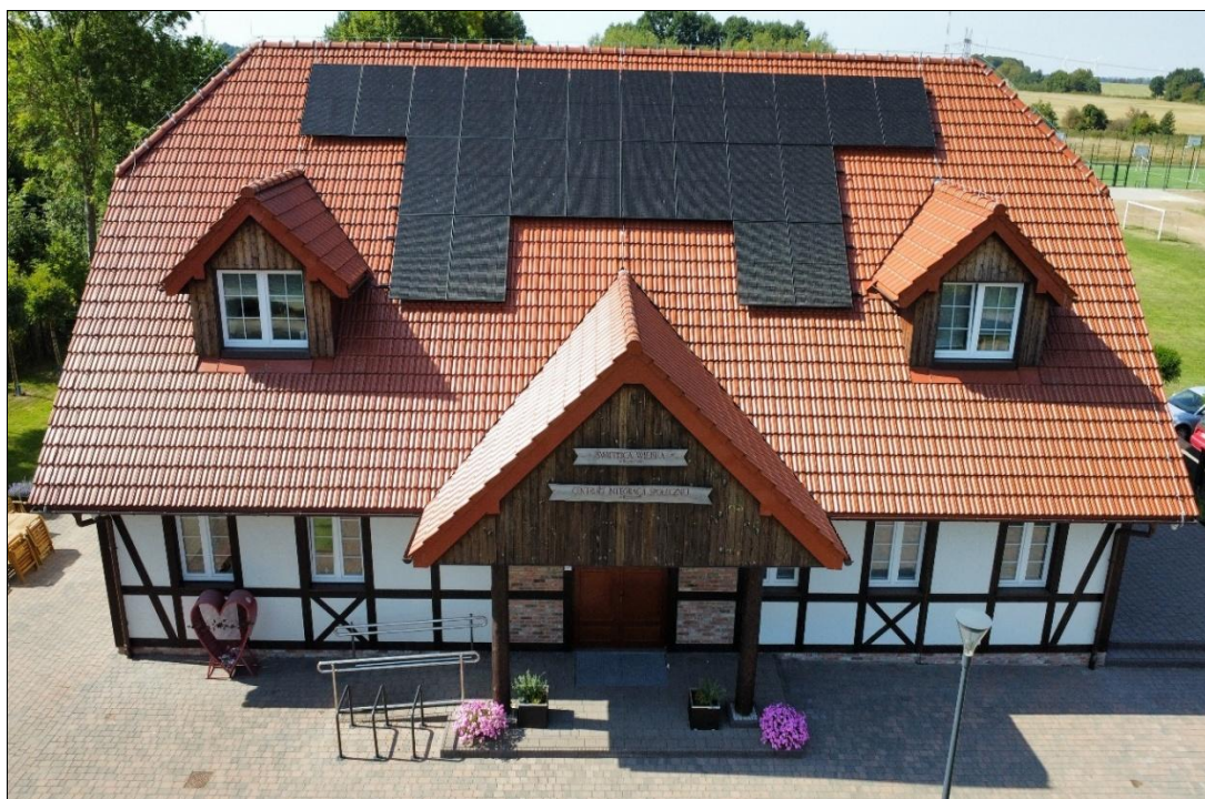
Instalacja fotowoltaiczna na budynku Centrum Integracji Społecznej w Rzyszczewie
