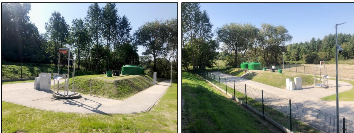
Biologiczna oczyszczalnia ścieków w Starým Krakowie
