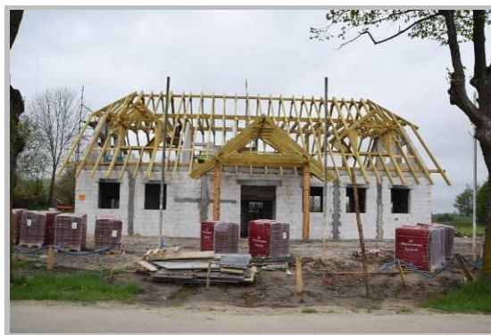
Budynek Centrum Integracji Społecznej w Rzyszczewie – w trakcie budowy (stan na dzień 07.05.2020 r.)
