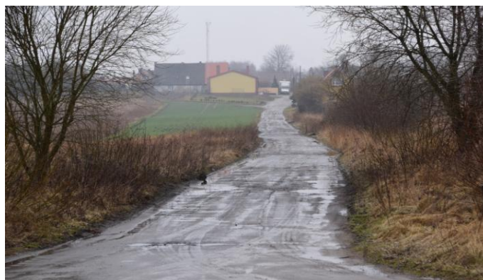
Fot. Droga w Noskowie - dojazd z koloni do wsi oraz główna droga w centrum wsi.
